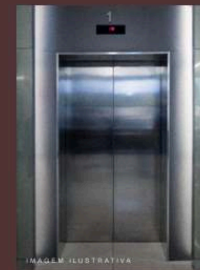
Elevador com porta inox nos andares.
